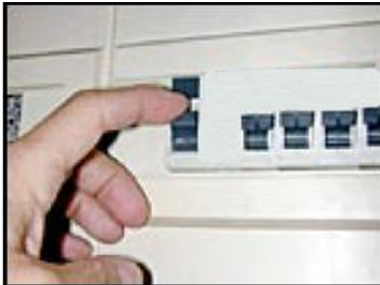
Figura 5.2 Manobra de um disjuntor automático em um quadro.
