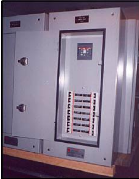
Figura 5.1 Quadro de distribuição para uso comercial.
