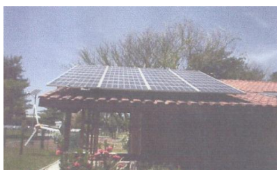
Figura 2.23. Sistema Fotovoltáico Fixo.
