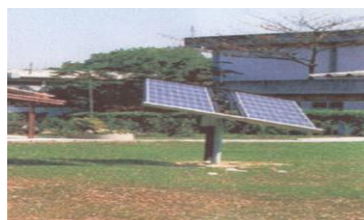
Figura 2.24. Sistema Fotovoltáico Móvel
